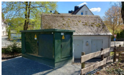
Neue und alte Trafo-Station
