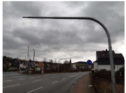
Bei der Ampelanlage auf der Briloner Straße fehlen noch die Lichtzeichen.
